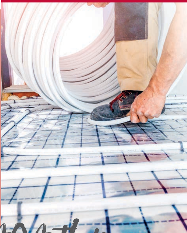
Påfyldning af varmesystemer
